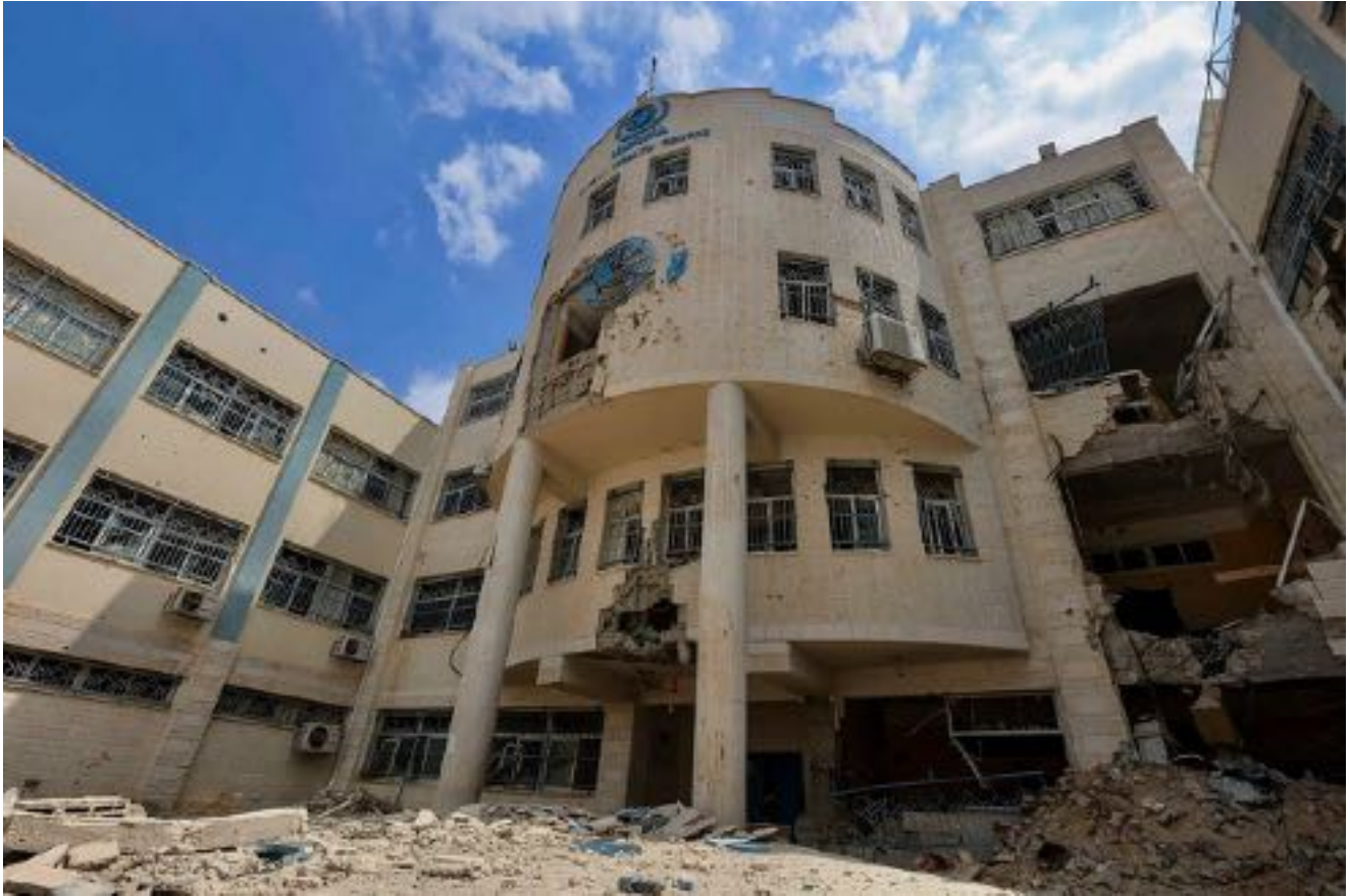
Veduta di un centro sanitario dell'UNRWA distrutto durante un'operazione militare israeliana a Rafah, 15 luglio 2024. (Oren Cohen/Flash90)
